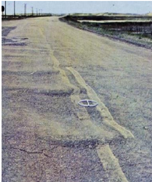
Figura 14- Ondulação (O) (Fonte: DNIT 005/2003-TER)
