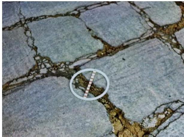
Figura 11 - Trinca tipo “bloco” (Fonte: DNIT-TER 005/2003)
