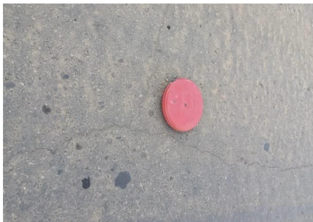
Figura 32- Encontro de trincas
