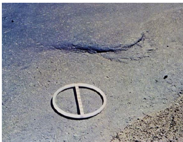
Figura 15 - Escorregamento (E) (Fonte: DNIT-TER 005/2003)
