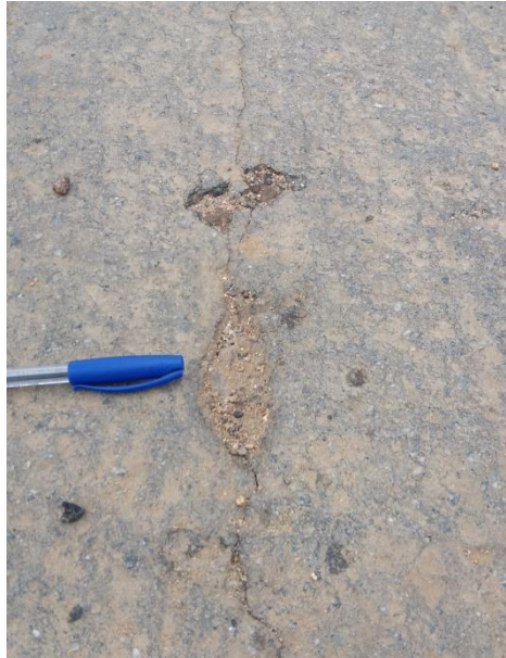
Figura 30 - Trinca Longitudinal Longa (TLL)
