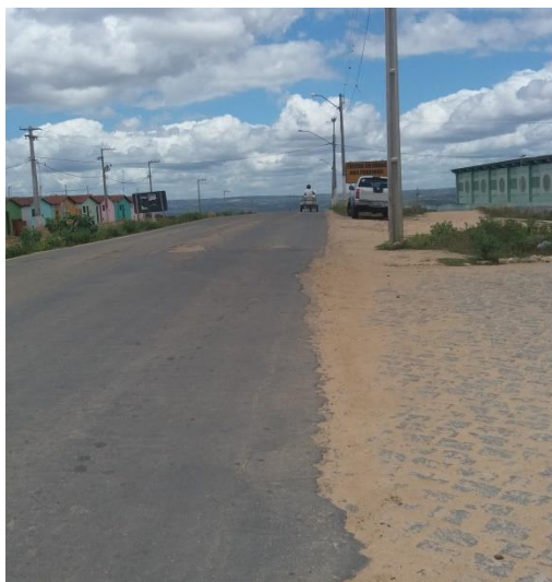
Figura 38 - Ausência de Acostamento
