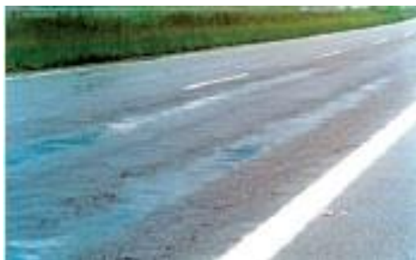
Figura 12 - Afundamento por consolidação de trilhas de rodas- ATC (Fonte: Bernucci, 2010)
