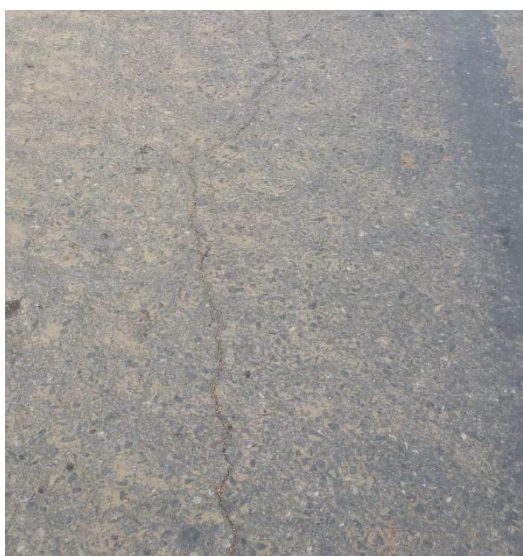
Figura 29 - Trinca Longitudinal Longa (TLL)
