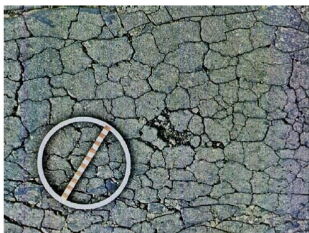
Figura 10 - Trinca tipo “couro de jacaré” (Fonte: DNIT -TER 005/2003)
