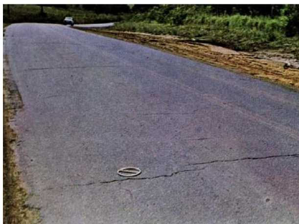
Figura 7 - Trinca Isolada Transversal (Fonte: DNIT - TER 005/2003)
