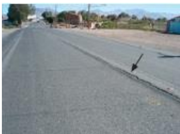
Figura 9 - Trinca de Retração (Fonte: Bernucci, 2010)
