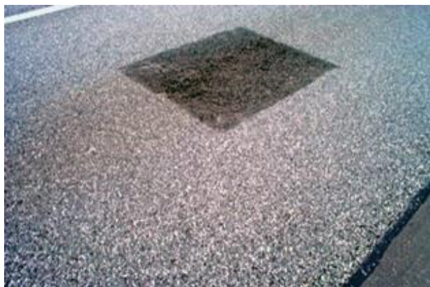
Figura 19 - Remendo bem executado (R) (Fonte: Bernucci, 2010)
