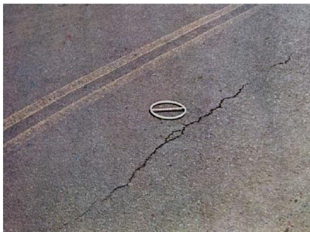
Figura 8 - Trinca Isolada Longitudinal (Fonte: DNIT- TER 005/2003)
