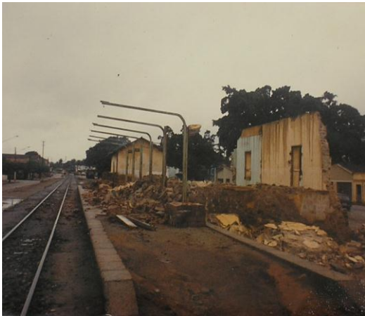
Figura 03: Destruição da estação ferroviária de Sapé. Foto: ROCK, 2007.
