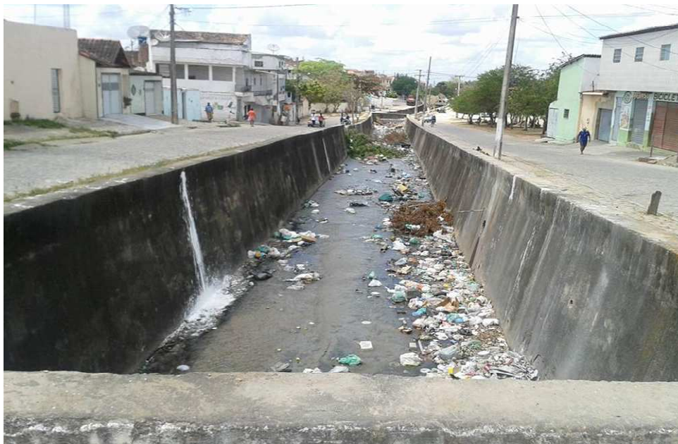
Figura 04: Canal das Piabas transformado em um grande esgoto a céu aberto – Bairro José Pinheiro, Campina Grande, 2016.
