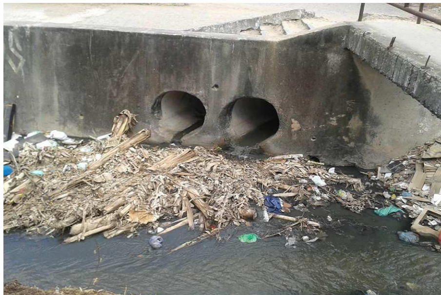
Figura 05 : Deposição de Esgotos – Médio Curso do Canal das Piabas no Meio Urbano, Campina Grande – PB Campina Grande, 2016.
