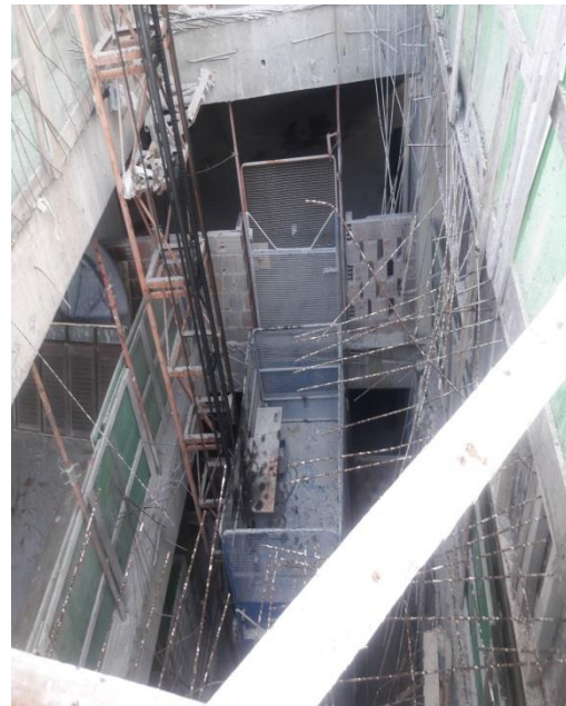
Figura 4 – Armadura exposta protegida
