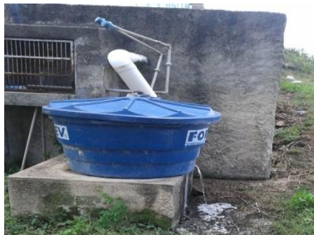
Figura 19 - Sistema de esgotamento sanitário do Bloco C do CCT - UEPB
