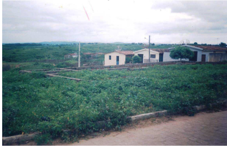
Figura 5 – Base da escola não concluída – Conjunto Achilles Leal – Mulungu - PB
