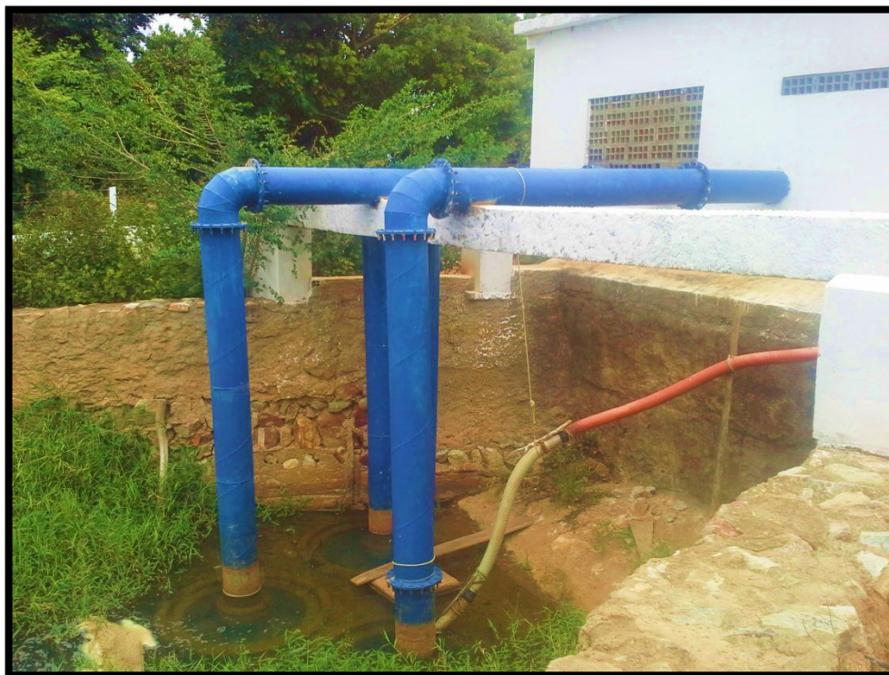
Figura 12: Sistema de bombeamento implantado no Assentamento SAFRA/PE
