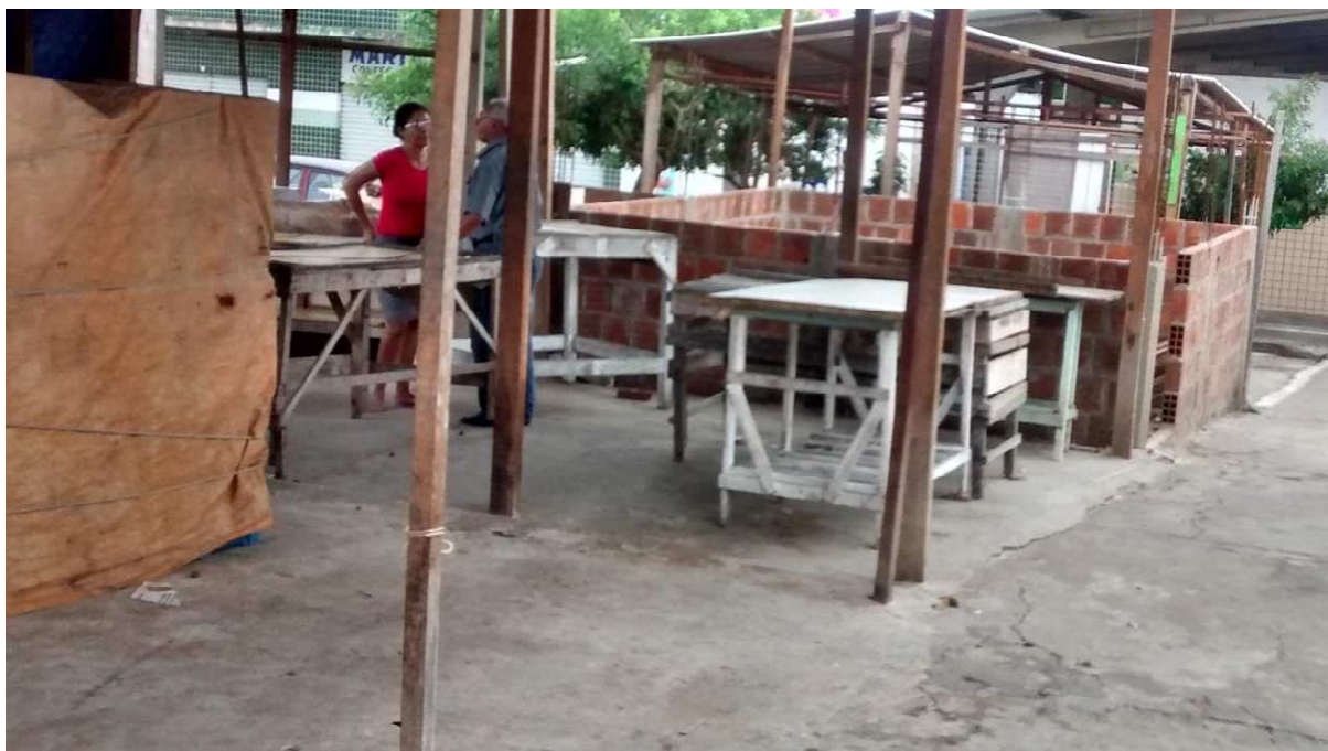
Figura 25 - Construções de alvenaria irregulares
