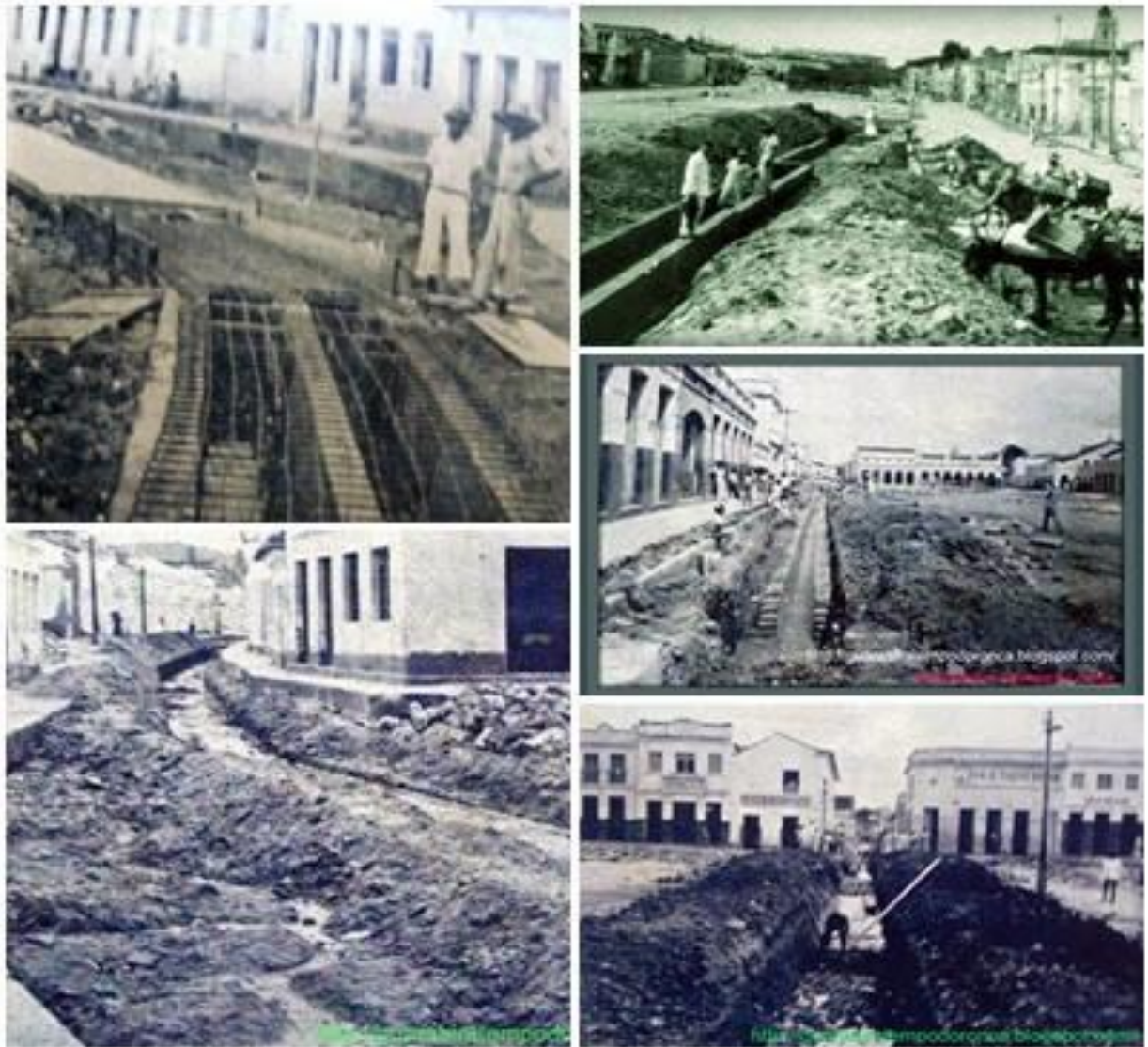
Box 01: Centro histórico de Guarabira, vários trechos de saneamento público e drenagens, S/D. Fontes: http://secultguarabira.blogspot.com.br/2010/11/as-primeiras-galerias-pluviais-de.html .
