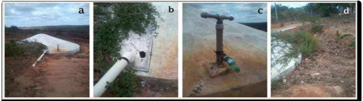
Figura 22. (a) Cisterna abandonada; (b) Buraco na entrada do duto que alimenta a cisterna; (c) bomba inutilizada para retirar água; (d) mato e sujeira acumulada ao redor da cisterna.
