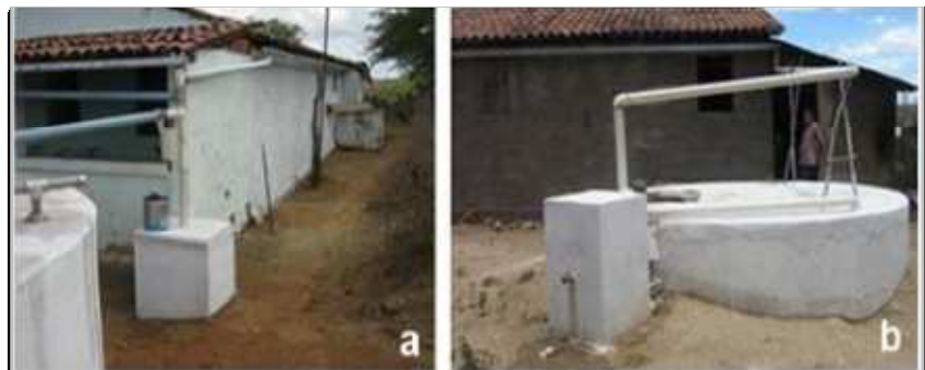
Figura 25. Cisternas com desvio das primeiras águas.
