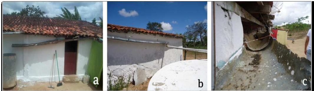
Figura 26. Irregularidades de sistemas de captação de famílias de Chã da Pia. A) Calha envergada; b) Calha fora da área de escoamento; c) Calha com sujeira acumulada.
