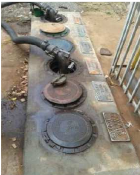
Figura 12 - Sistema de armazenamento subterrâneo de lubrificantes usados.
