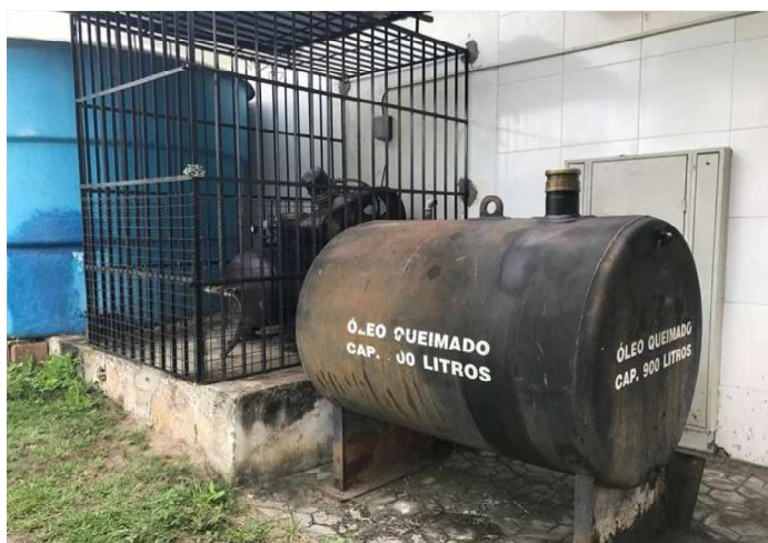
Figura 11 - Sistema de armazenamento aéreo de lubrificantes usados.
