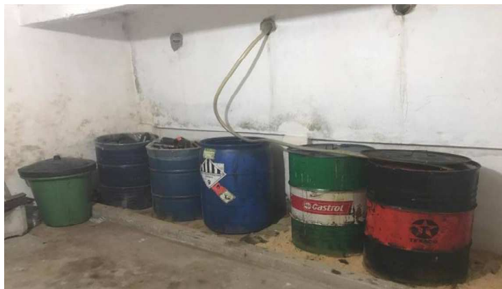
Figura 10 - Sistema de armazenagem de óleo lubrificante de 200 litros.
