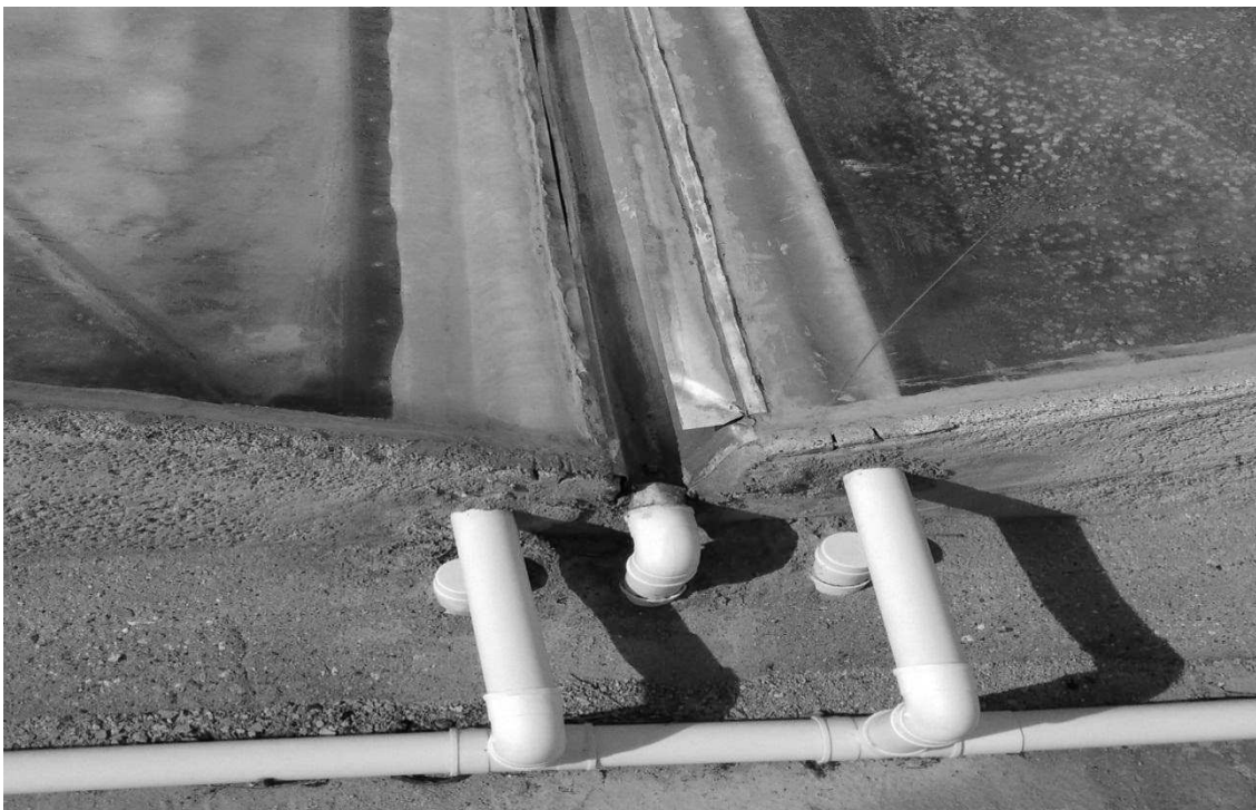
Figura 8: Canalizações internas de alumínio e canos de PVC para condução da água potável Fonte: Arquivo pessoal, 2017
