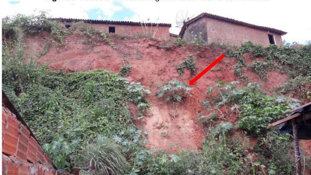
Figura 9- Encosta com escorregamento constante de materiais.
