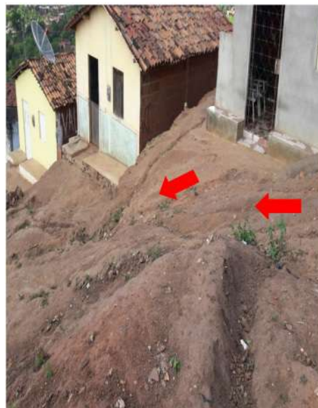
Figura 8- Sulcos e ravinamentos em uma rua local.
