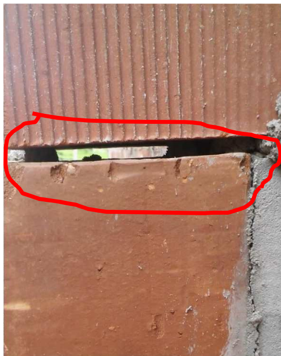
Figura 38: Falta de junta de argamassa entre os blocos.
