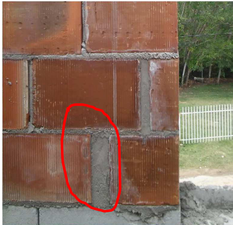
Figura 39: Excesso da junta de argamassa
