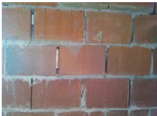
Figura 23: Juntas com preenchimento inadequado.
