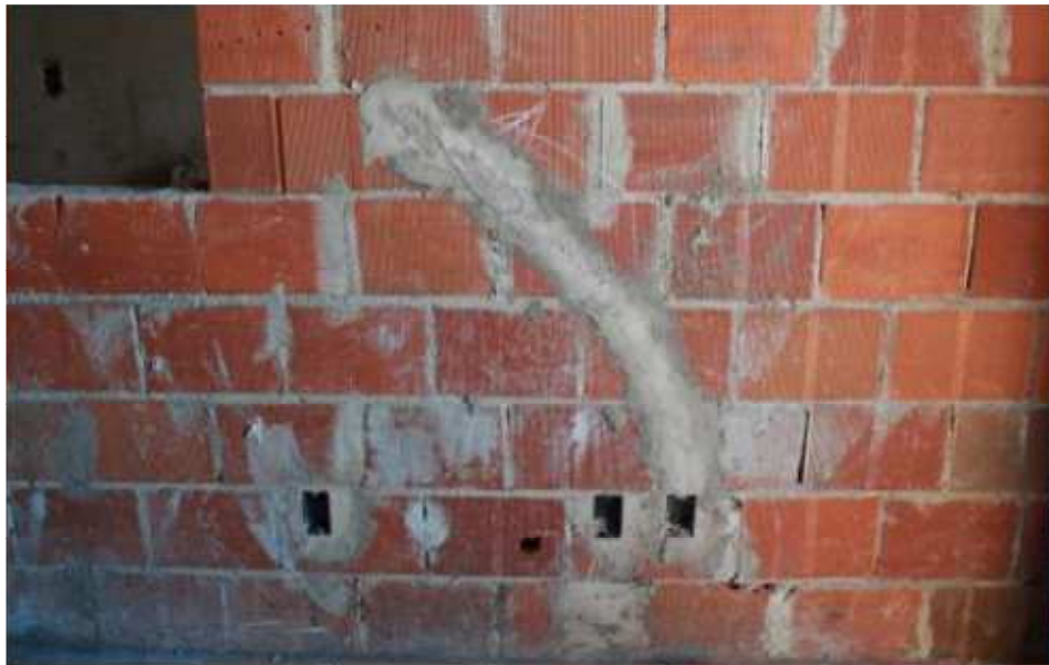
Figura 26: Rasgo indevidos na alvenaria.
