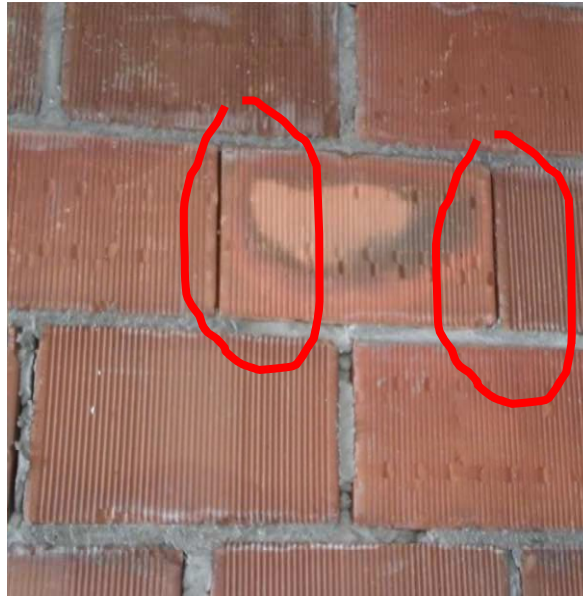
Figura 37: Blocos sem espaço para junta de argamassa.
