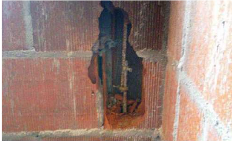
Figura 27: Ponto com grauteamento inadequado.
