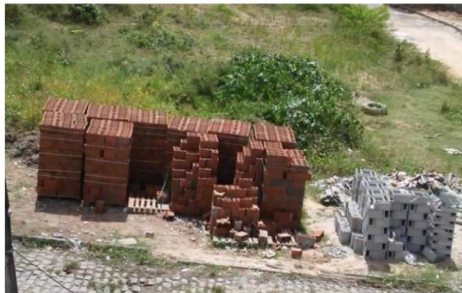
Figura 42: Armazenamento indevido de materiais.
