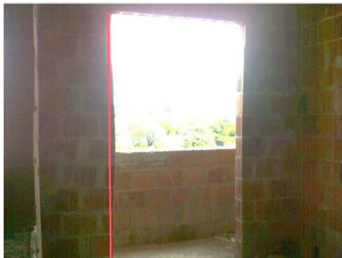
Figura 25: Falta de prumo na parede.
