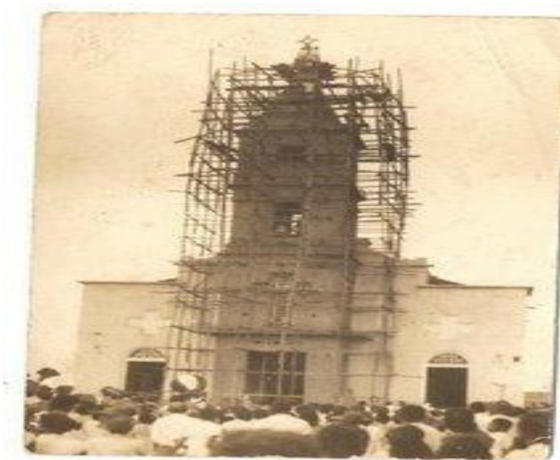
FOTO 7: Matriz de Santa Ana em construção Fonte: Acervo particular do Diácono Ladislau Nogueira (1939)
