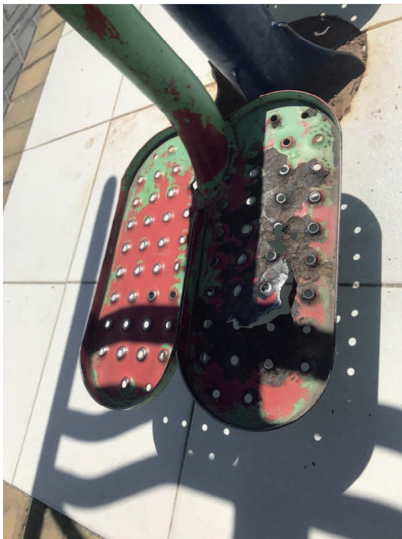
Figura 5: Equipamento enferrujado e danificado
