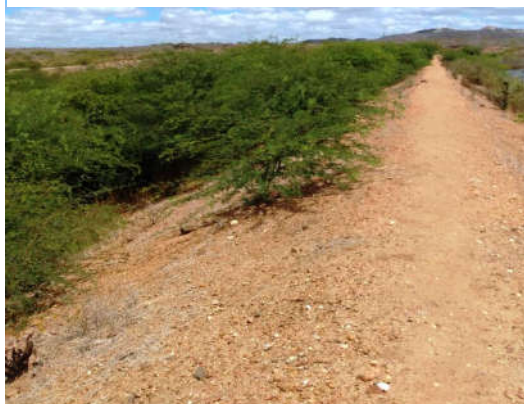
Figura 36 - Anomalias do coroamento e talude de jusante (Algodões)
