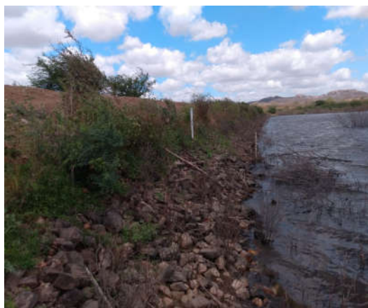
Figura 34 - Anomalias do talude de montante (Algodões)
