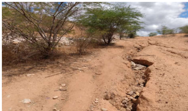
Figura 46 – Erosão no encontro da ombreira esquerda do talude de jusante
