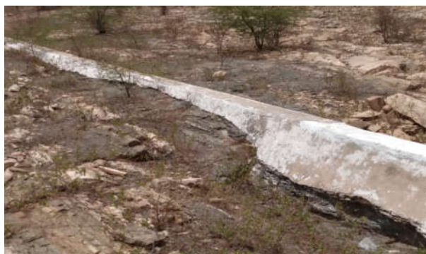
Figura 32 - Deterioração da soleira do vertedouro (Poleiros)
