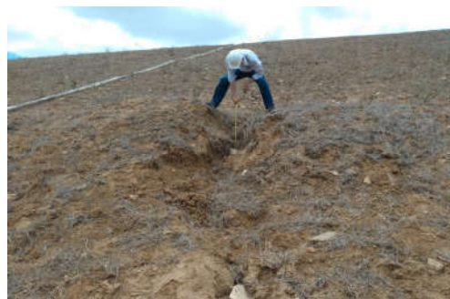
Figura 31 - Anomalias do talude de jusante (Poleiros)
