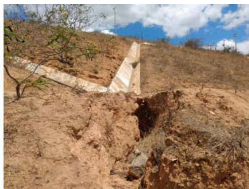
Figura 45 - Erosão (ravinas) no talude de jusante (Jandaia)
