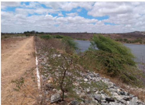
Figura 28 - Anomalias no talude de montante (Poleiros)
