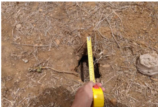
Figura 30 Formigueiro na crista da barragem (Poleiros)
