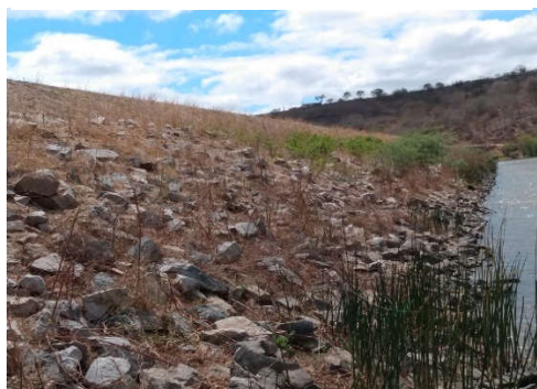
Figura 23 - Anomalias do talude de montante (Curimataú)
