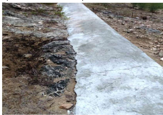
Figura 42 – Deterioração do vertedouro (Cacimba de Várzea)
