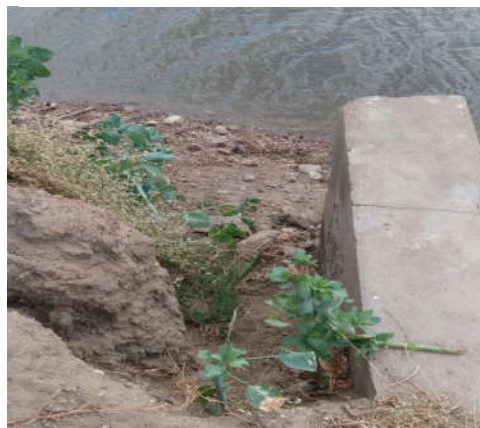
Figura 35 - Erosão no encontro da ombreira esquerda (Algodões)
