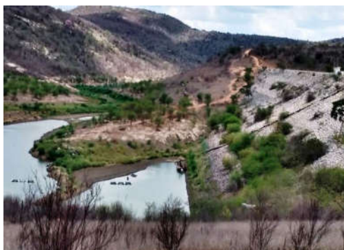
Figura 44 – Presença de árvores no talude de montante(Jandaia)
