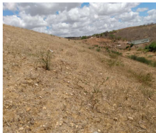
Figura 41 - Anomalias do talude de jusante (Cacimba de Várzea)
