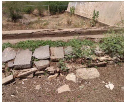
Figura 37 - Deterioração da soleira do vertedouro (Algodões)
