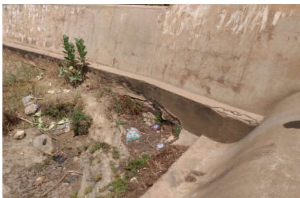
Figura 38 - Erosão na fundação do muro lateral (Algodões)
