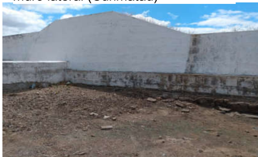
Figura 25 – Erosão na fundação do muro lateral (Curimataú)
