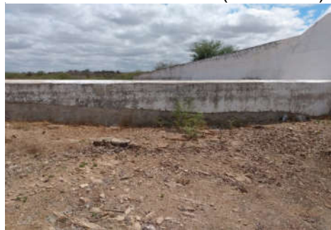
Figura 26 – Deterioração do concreto da soleira do vertedouro (Curimataú)
