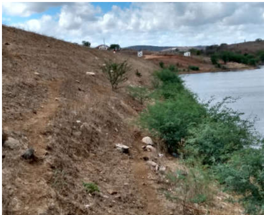
Figura 40 - Anomalias do talude de montante (Cacimba de Várzea)
