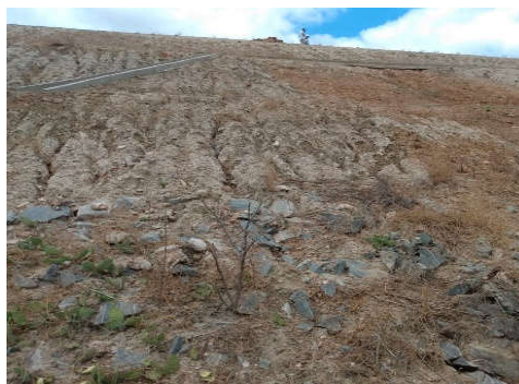
Figura 24 - Anomalias do talude de jusante (Curimataú)
