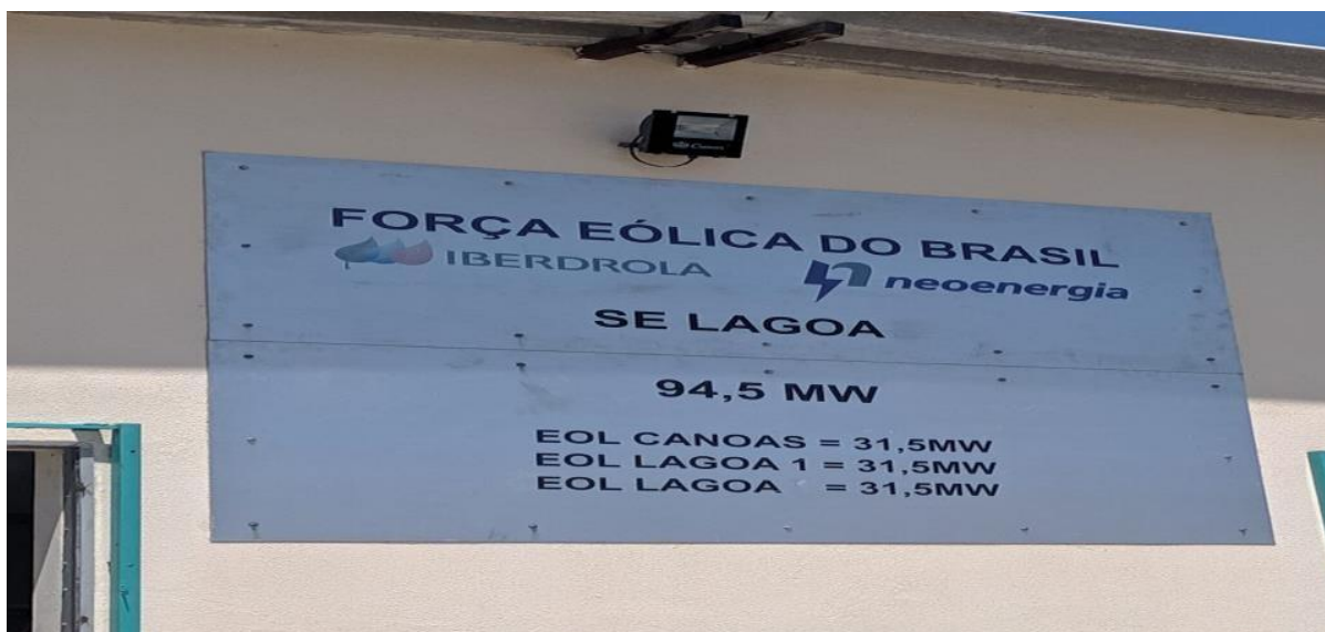
Figura 7 - Subestação de energia elétrica do complexo eólico de Santa Luzia
