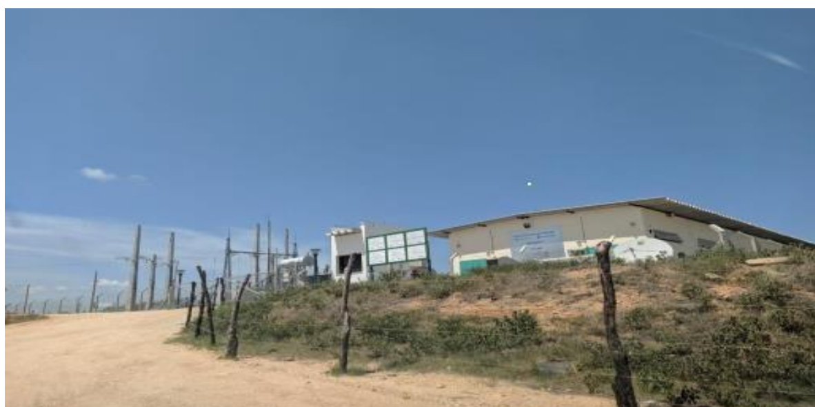
Figura 5 - Subestação de Santa Luzia, Paraíba
