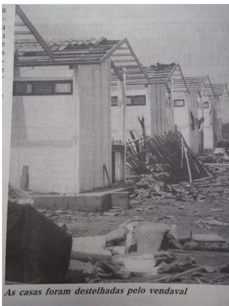
Figura 2 – Registro de algumas moradias parcialmente destruídas pelo vendaval.
