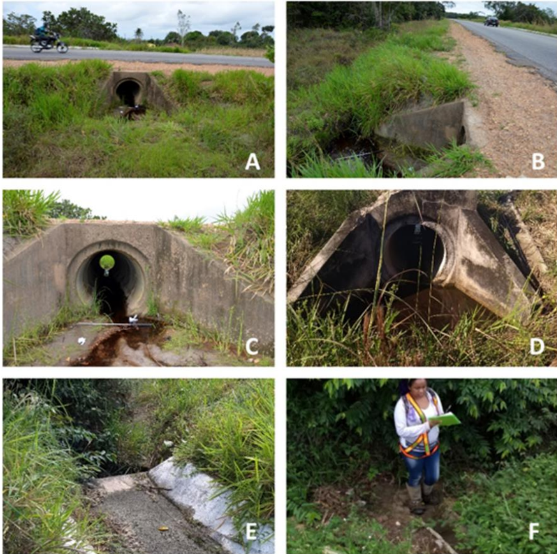
Figura 4. Rede de drenagem de água pluvial registrada ao longo do trecho monitorado da rodovia estadual PB-071 no entorno da SEMA II (Reserva Biológica Guaribas, município de Mamanguape, estado da Paraíba, Nordeste do Brasil). Abreviaturas: A - F (Bueiros para drenagem de água das chuvas), e em F (Pesquisadora procurando por carcaças de répteis, possivelmente arrastadas para a borda da mata através de uma canaleta de drenagem d'água das chuvas). Fotos: Gindomar Gomes Santana (2018).
