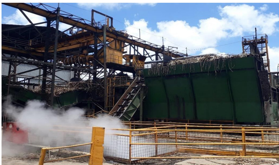
Figura 3: Sistema de recepção, controle, descarga e limpeza da cana
