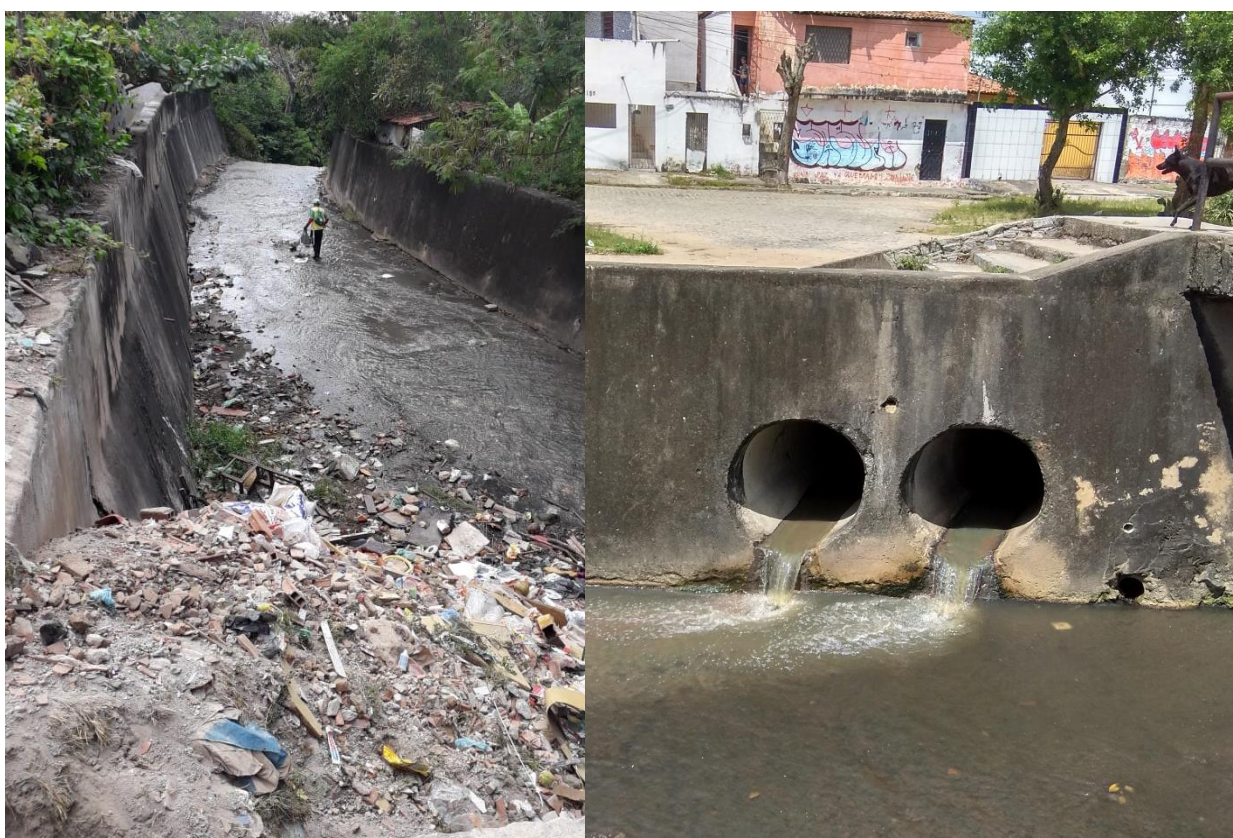
Figura 13 – Lançamento de resíduos e contribuição de esgoto no canal.
