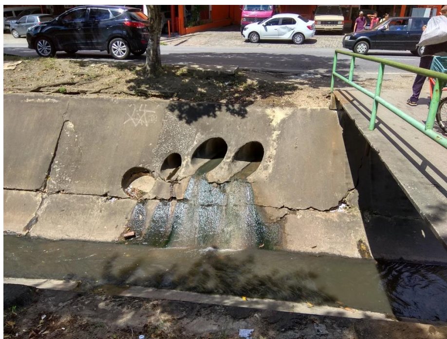
Figura 16 – Ponto de lançamento de esgoto E 3 .
