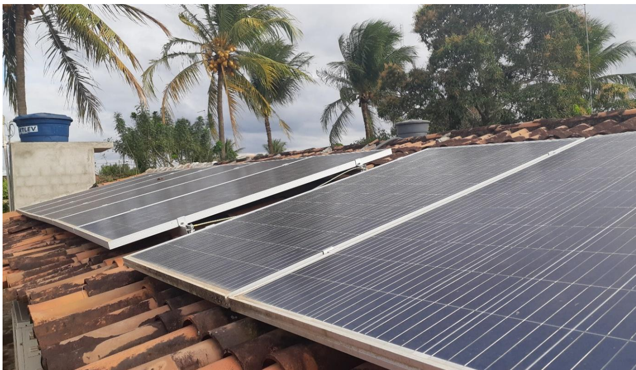
Figura 4 – Painéis solares instalados no telhado de residência Mari-PB.
