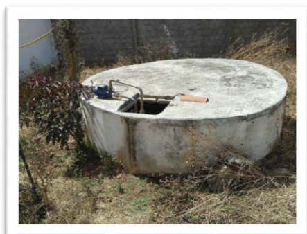
Figura 5: Cisterna sem tampa.
