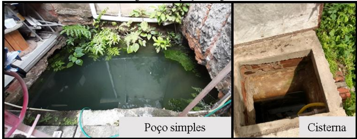
Figura 7 – Captação de água
