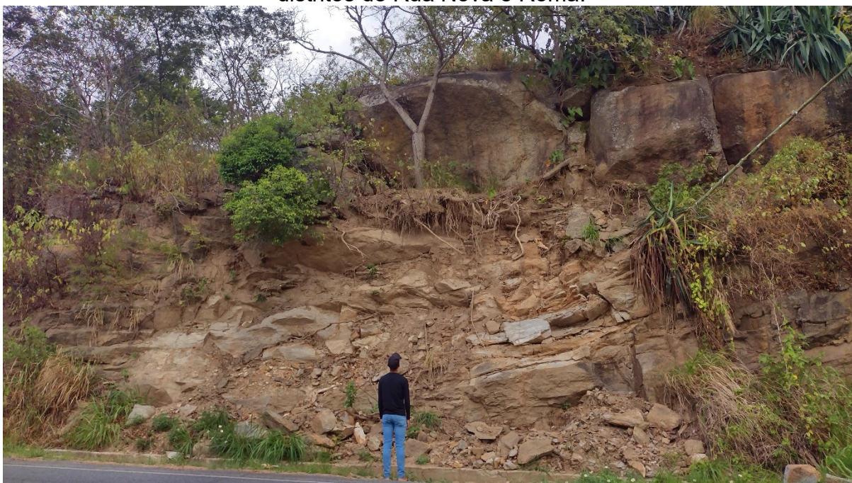
Figura 12: Cicatriz de queda de blocos encontrada na Rodovia PB-105, entre os distritos de Rua Nova e Roma.
