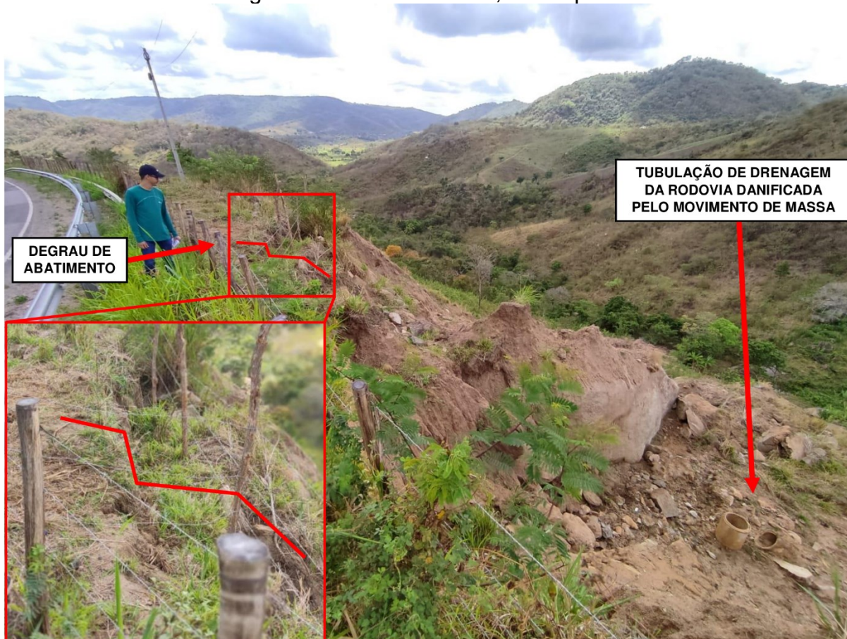
Figura 14: Cicatriz de movimento de massa do tipo escorregamento rotacional identificada na margem da Rodovia PB-105, município de Bananeiras-PB.
