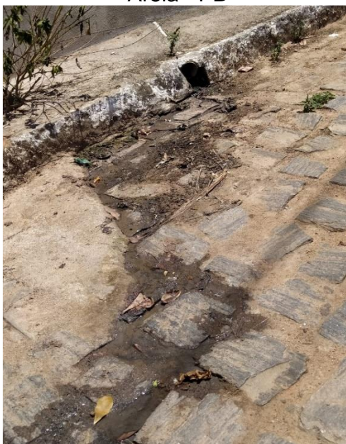
Figura 17 – Esgoto à céu aberto na comunidade de Chã da Pia no município de Areia - PB
