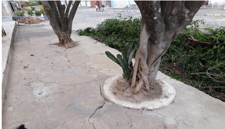
Figura 6. Ficus Benjamina danificando calçada, na rua Flávio Ribeiro BELÉM/PB.
