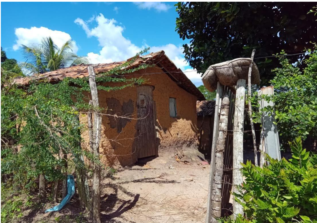
Figura 04: Condição de moradia na Comunidade Cubinha
