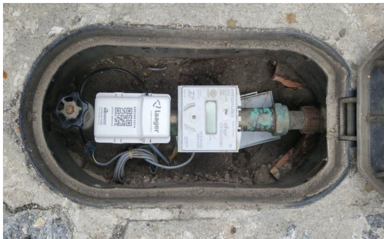
Figura 4 – Equipamento de telemetria acoplado ao hidrômetro já predisposto.
