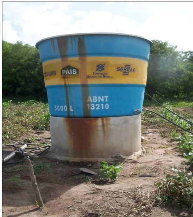
Figura 1 - Reservatório de água utilizado no PAIS
