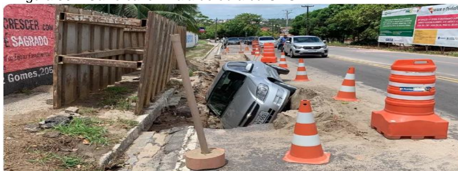
Figura 30 – Carro cai em vala de obra da CAGEPA
