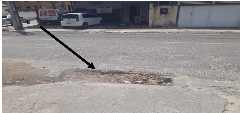
Figura 14 – Presença de resíduos e sedimentos sólidos próximo a área de escoamento da água
