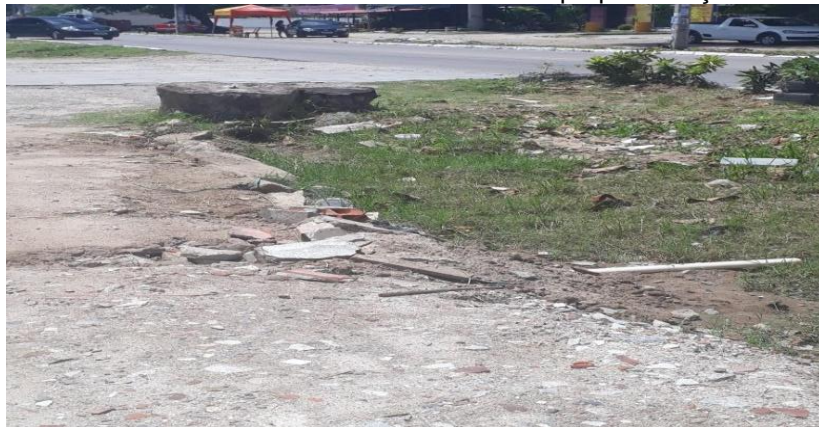
Figura 24 – Processo de erosão do solo com uma pequena voçoroca iniciada
