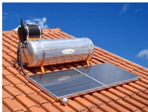
Figura 11 - Aquecedor solar de água.
