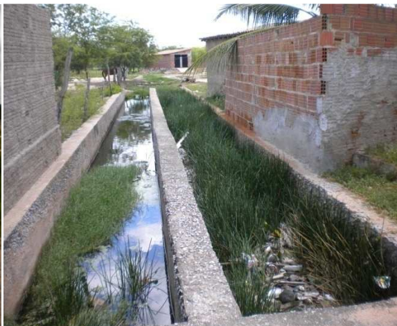
FIGURA 11: Esgoto e lixo, lançados no riacho.
