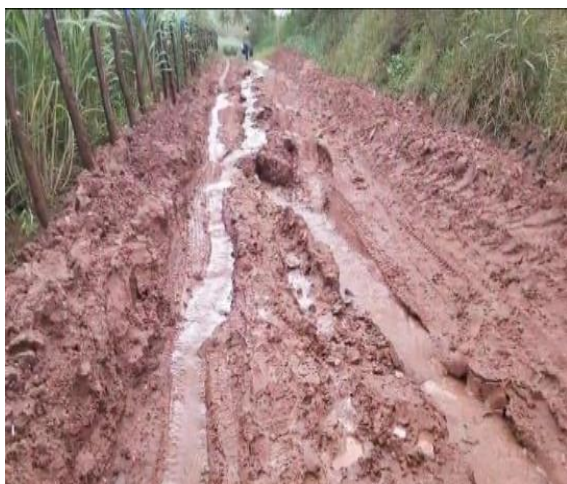
Figura 1 – Estrada que dá acesso à cidade Alagoinha – PB em dias chuvosos.
