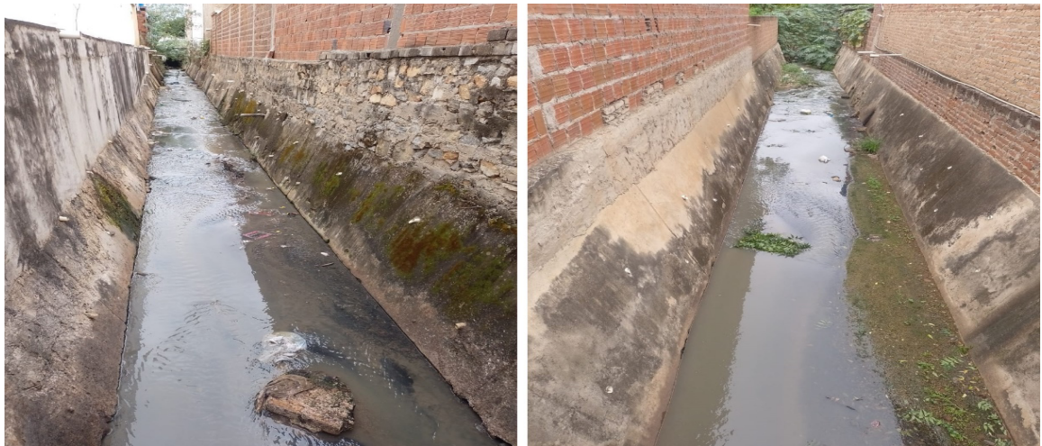
Figura 8. Lançamento de esgotos no Rio Paraíba
