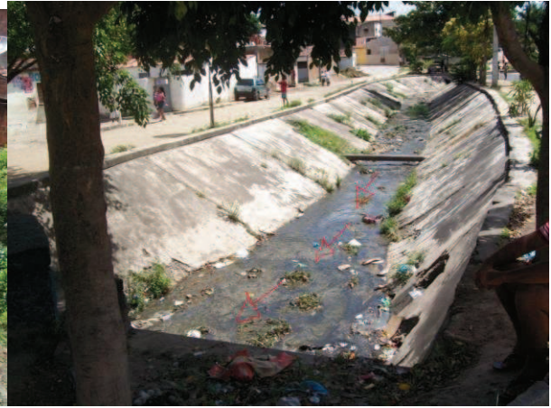
Figura 17: Trecho canalizado, onde se acumula resíduos sólidos Fonte: Pesquisa de campo, junho de 2012.
