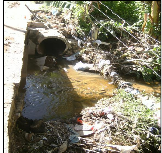
Foto 9: Esgoto direcionado ao Riacho da Serra, D. Inês/PB. Fonte: SANTOS, 2013
