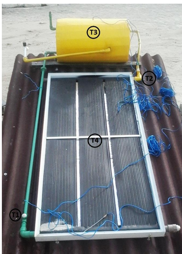
Figura 11: Sistema de aquecimento solar.
