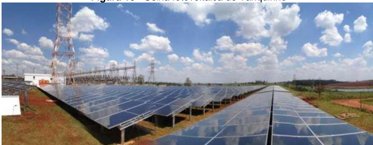
Figura 15 - Usina fotovoltaica de Tanquinho
