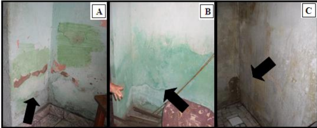
Figura 9- Paredes com problemas de infiltrações nas residências de Fagundes (A e B) e Pocinhos (C), Paraíba, NE do Brasil, 2011.
