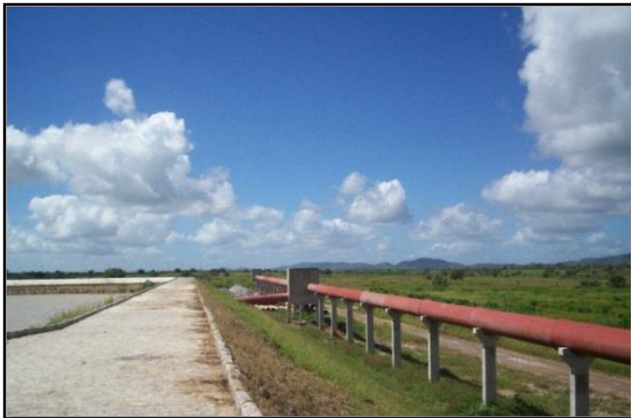
Figura 11 - Detalhe Do Emissário Que Transporta O Efluente Até As Lagoas Facultativas.
