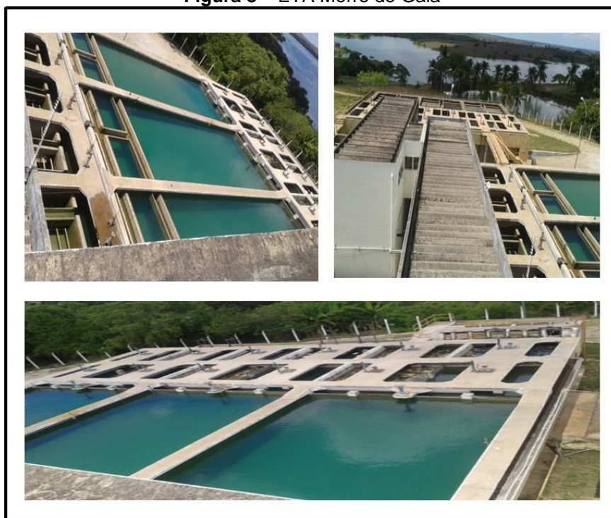
Figura 8 – ETA Morro do Gaia
