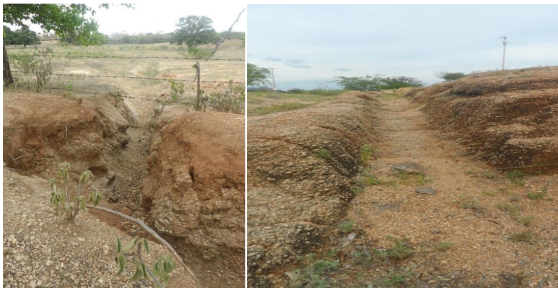
Foto 11. Erosão Voçorocas – Bairro Petrópolis – Pombal-PB Fonte: (TOMAZ; NETO, 2014)
