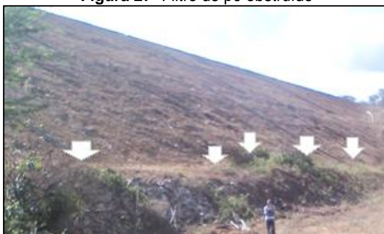
Figura 27- Filtro de pé obstruído
