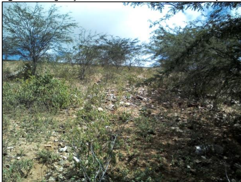
Figura 9- Vegetação alta e excessiva no talude de jusante
