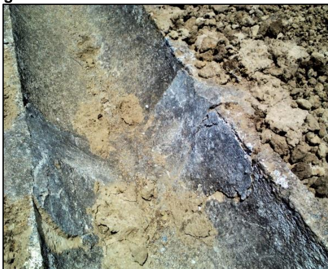
Figura 23- Canaleta com selo de concreto trincado
