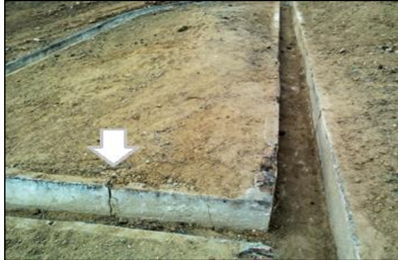
Figura 17- Canaleta trincada e com desgastes
