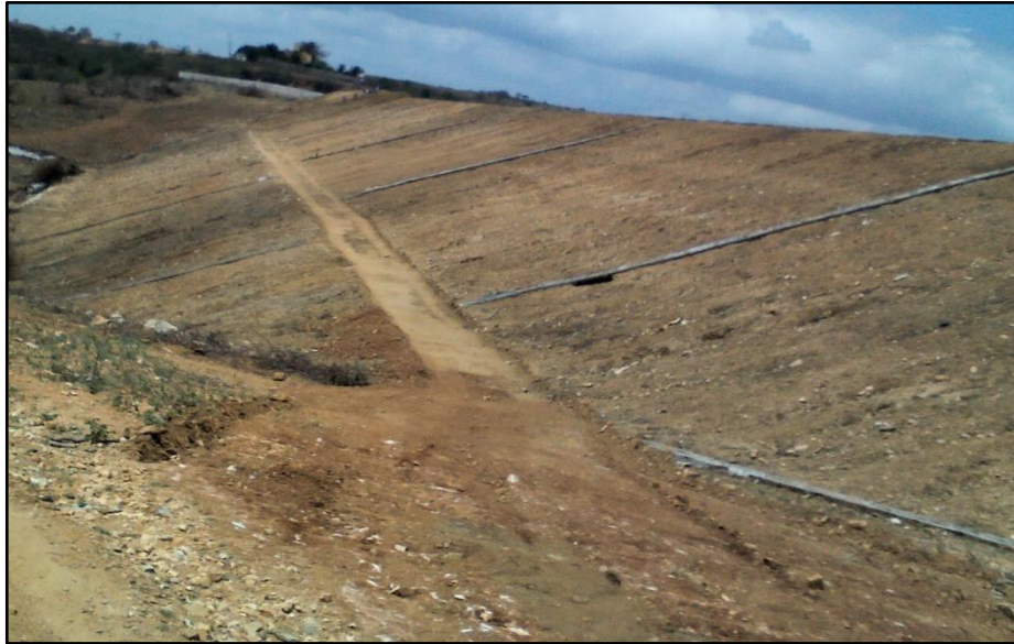
Figura 33- Talude de jusante desmatado
