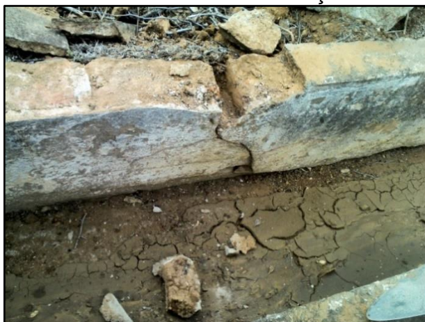
Figura 20- Canaleta com trincas e indicações de tombamento
