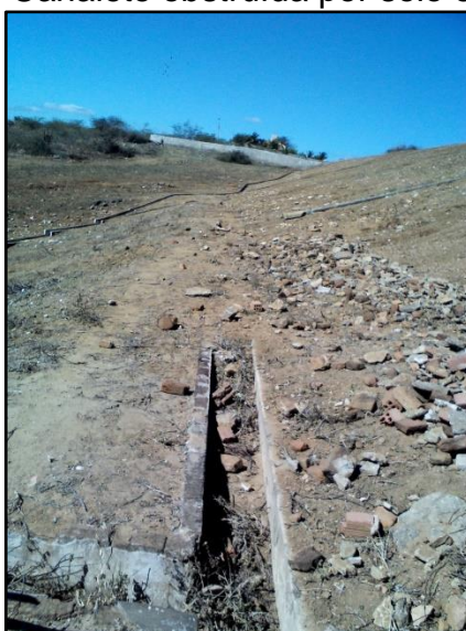
Figura 16- Canaleta obstruída por solo e vegetação
