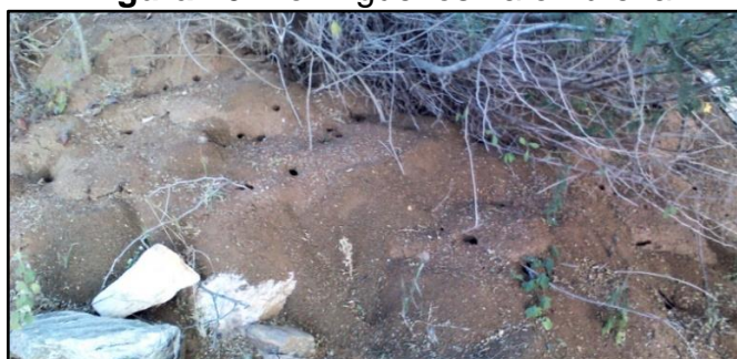
Figura 26- Formigueiros na ombreira
