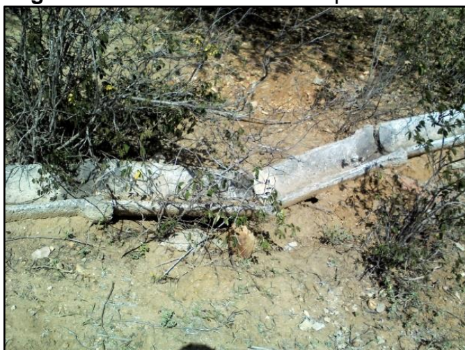
Figura 22- Canaletas com recalque e fissuras
