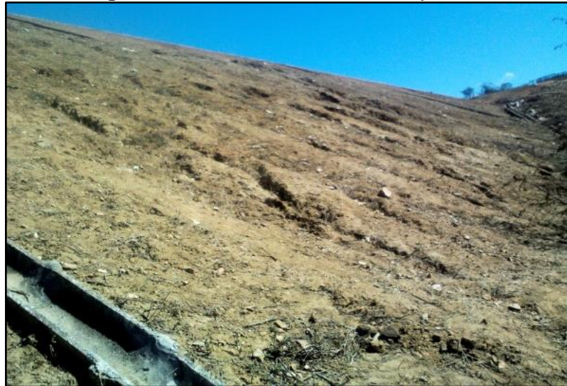
Figura 13- Erosões no talude de jusante
