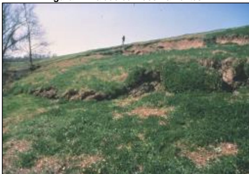
Figura 2 - Talude com deslizamentos.
