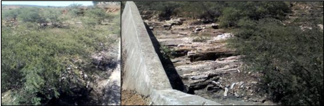
Figura 11- Vegetação excessiva no vertedouro
