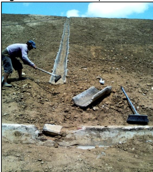
Figura 24- Canaleta com parte destruída
