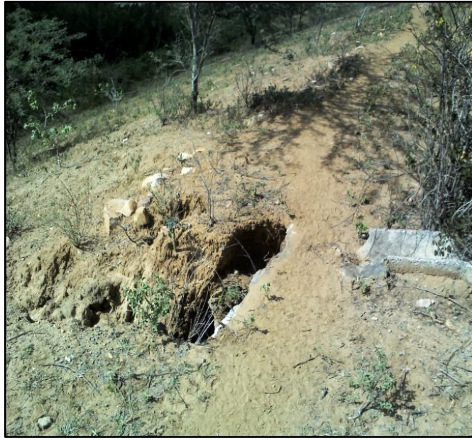
Figura 14- Erosões desenvolvidas no talude de jusante
