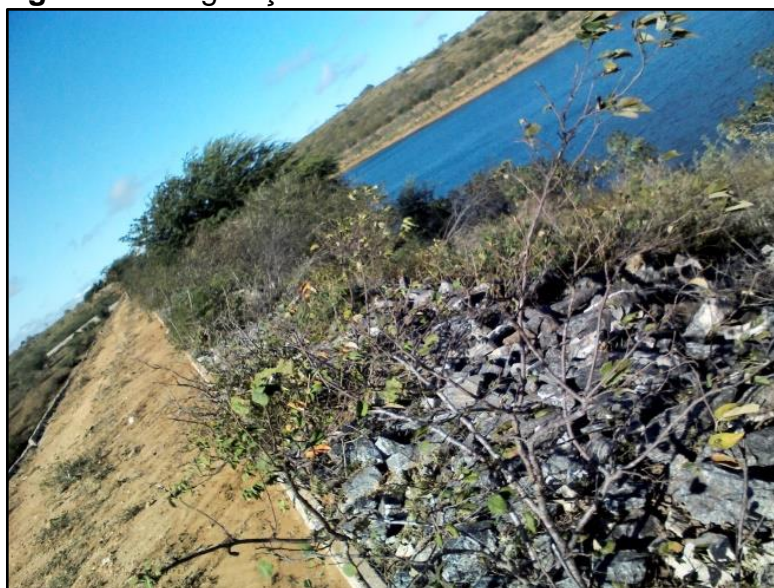
Figura 10- Vegetação excessiva no talude de montante
