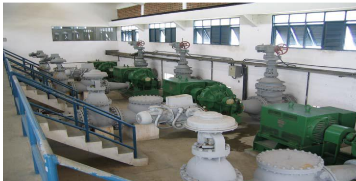
Figura 4: Estação de água tratada em gravatá Fonte: Albuquerque (2007, p. 43)
