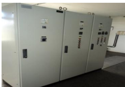
Figura 15: Quadro de comandos das motobombas e local de verificação de amperagem e voltagem do sistema da estação elevatória de água de Boa Vista – PB.
