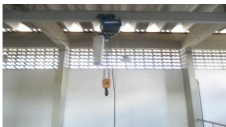
Figura 8: Talhar sobre ponte rolante, além das vigas e aberturas para livre movimentação dos equipamentos da estação elevatória de água de Boa Vista – PB.
