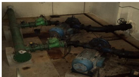
Figura 6: Salão de bombas com tubulações de sucção e recalque e acessórios da estação elevatória de água de Boa Vista – PB.
