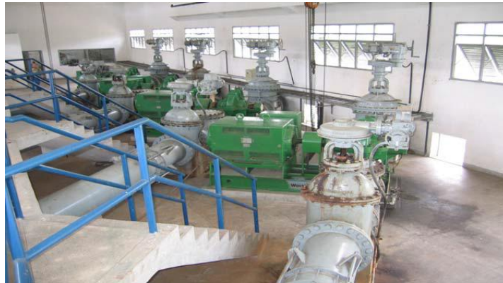
Figura 3: Casa de bombas da estação elevatória de água bruta. Fonte: Albuquerque (2007, p. 39)
