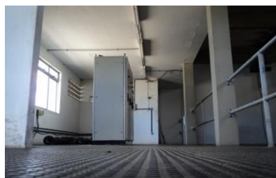
Figura 13: Piso da estação elevatória de água de Boa Vista – PB.
