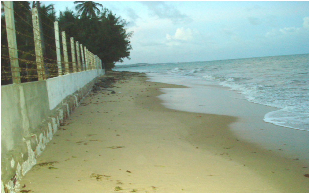
Figura 20 – Artificialização da linha de costa na praia de Maria Farinha, próximo a rua das Carpas.
