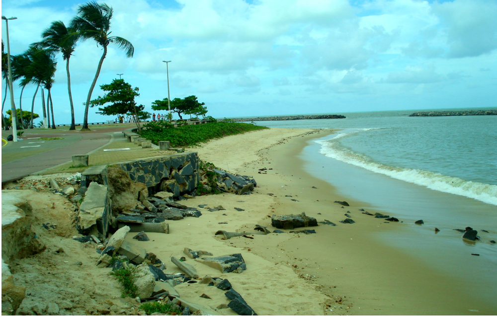
Figura 25 – Destruição do muro de proteção do calçadão na praia do Janga, em novembro de 2011.
