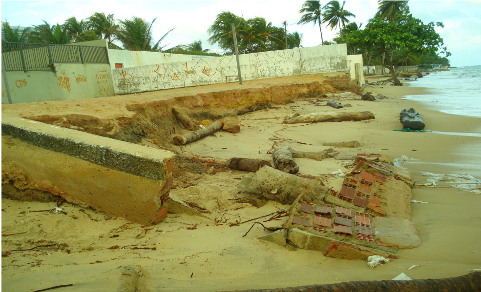
Figura 23- A destruição de muro de residência situada no estirâncio da praia de Pau Amarelo, no setor 2.
