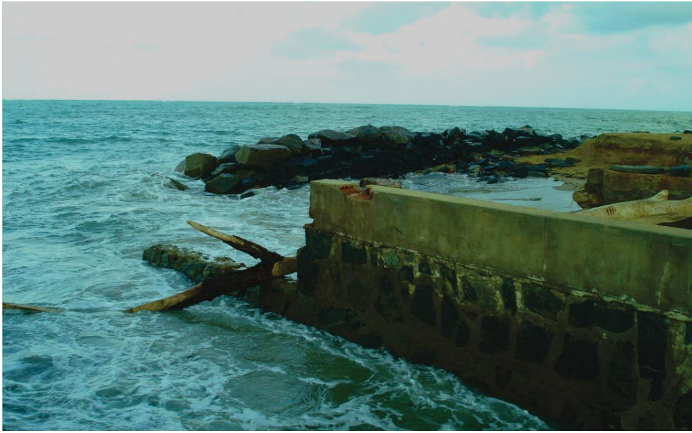
Figura 27 – Destruição da desembocadura do canal para escoamento pluvial e flúvio-lagunar na praia de Pau Amarelo, em novembro de 2011.
