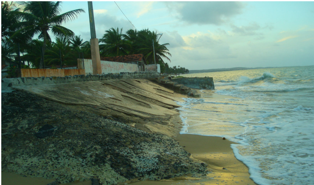
Figura 31 – Na praia de Maria Farinha a presença de rampas em residência para minimizar processos erosivos.
