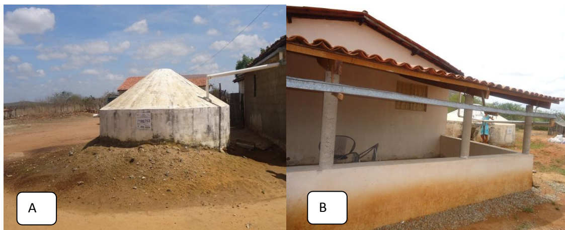
Figura 14: Inadequações de sistemas de captação de água de chuva no sertão/PB
