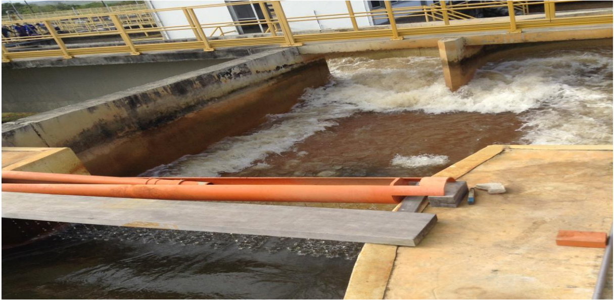
Figura 4 – Canaleta Parshall da ETA de Gramame, João Pessoa-PB
